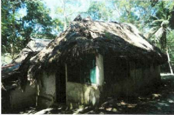
Figura 027. Estado de la infraestructura antes de iniciar con el proceso de remozamiento. El resto del campamento se encuentra en condiciones similares
