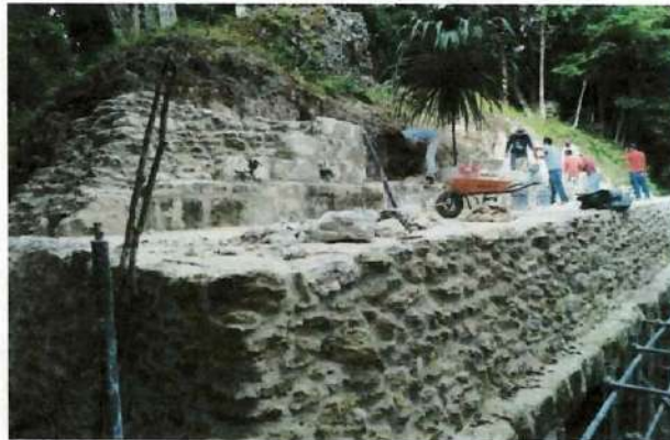
Edificio 389- proceso de trabajo, visto desde la esquina noreste, trabajo realizado en la cornisa a lo largo de toda el área restaurada.
