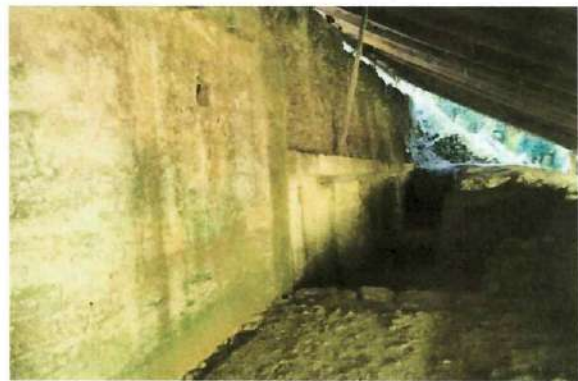
Figura 024. Edificio 6J2, Muros por debajo de la cubierta antes de desmontarse, se puede ver el exceso de humedad que los está afectando.
