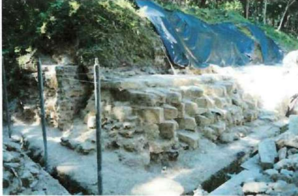
Edificio 389- proceso de trabajo, visto desde la esquina noreste, trabajo realizado en la cornisa a lo largo de toda el área restaurada.
