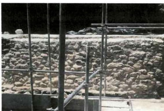
Figura No. 022. Edificio 375- Proceso del trabajo de recuperación de volumen removido en la parte superior del edificio.
