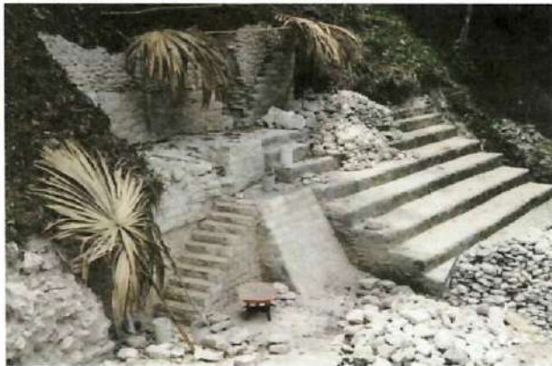
Figura No. 010. Edificio B-17, proceso de la restauración de arquitectura expuesta y el avance de los trabajos.
