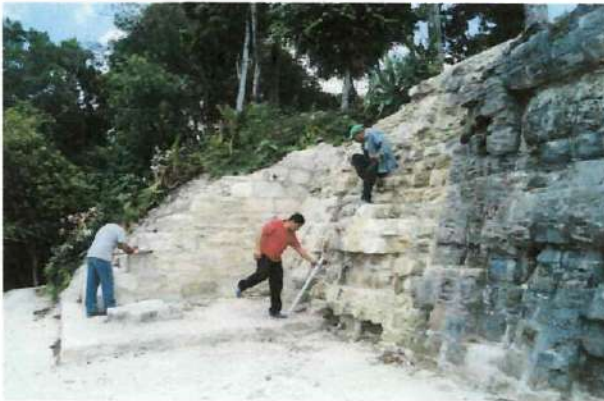
Figura No. 008. Edificio B-24, personal que se encuentra realizando dibujos a escala del muros norte donde se encuentran los relieves una vez terminados los trabajos de restauración.
