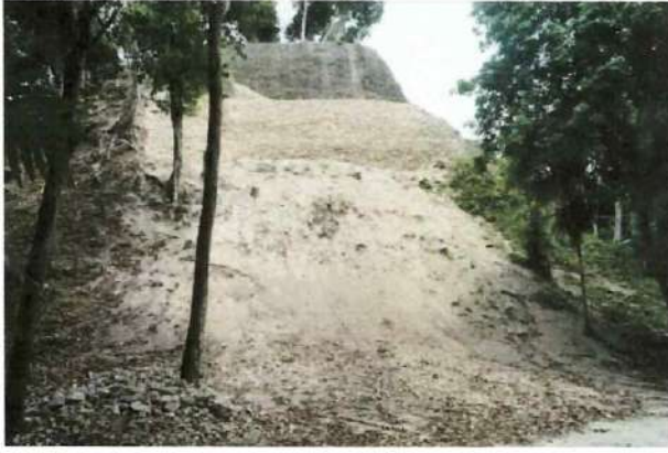
Figura No. 007. Edificio B-24, fachada norte, resultado del trabajo en la recuperación de volumen en los cuerpos de la pirámide.
